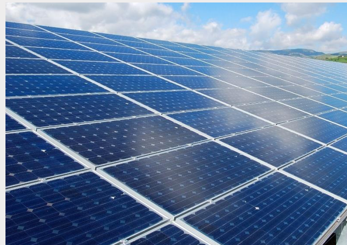
Placas solares entregues no condomínio
